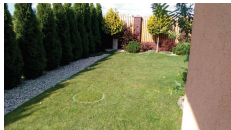
Oczyszczalnia z pokrywą KAMELEON wkomponowana w trawnik
