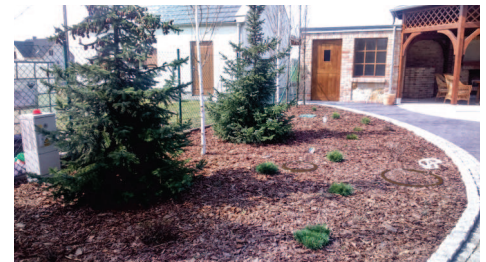
Oczyszczalnia SBR Primo+ z pokrywami KAMELEON wkomponowana w korę
